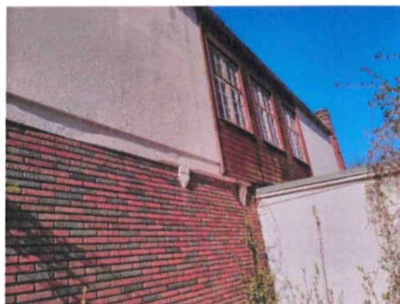
Foto 16: Außenansicht der Nordostfassade mit Holzfassadenverkleidung im OG des Gebäude A, Blickrichtung Nordwest (09.04.2020).
