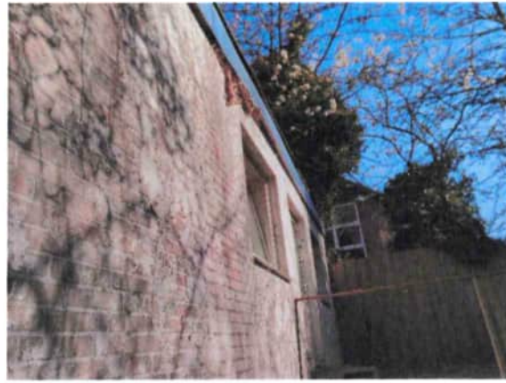
Foto 26: Außenansicht der Südostfasade mit Blick auf die Flachdachabschlussverkleidung des Gebäude G, Blickrichtung Nordost (14.09.2020).
